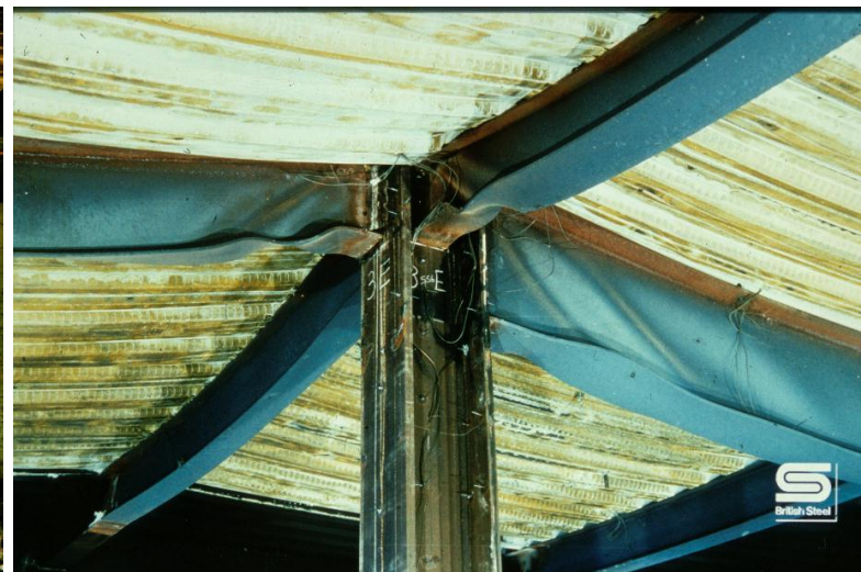
Deformeerunud terastalad tulekaitsega posti ümber
