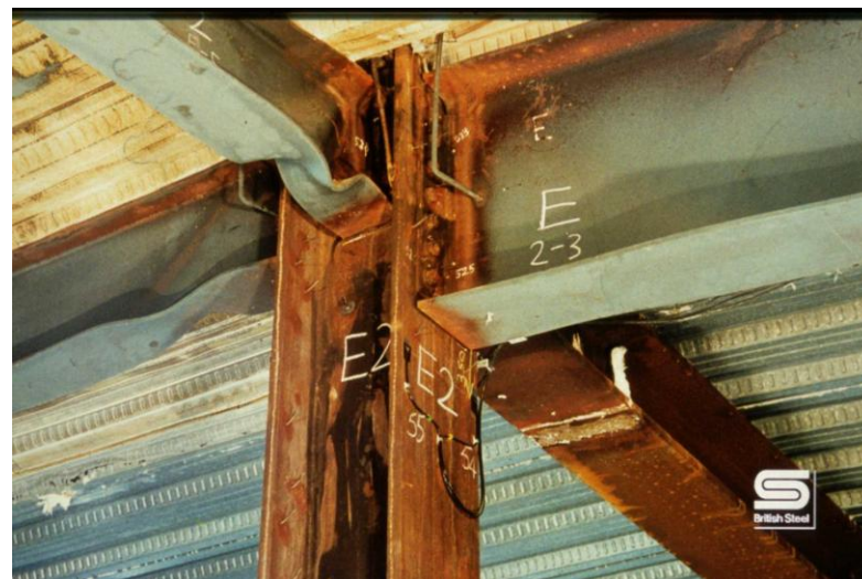
Tulekaitsega posti ümber olevate teraselementide deformeerunud olga
